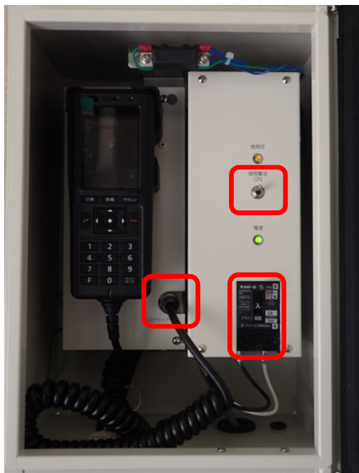
延長型(公民館内)外部接続箱内
