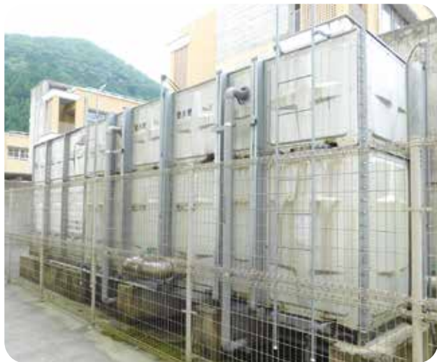
中学校設置の井水タンク
