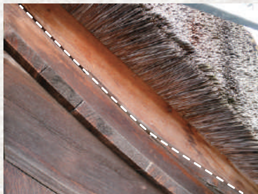
▲点線の上が後から追加された部材 色の違いからも新しい材料だとわかります
