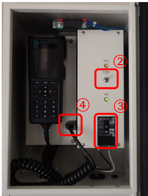
延長型(公民館内)外部接続箱内
