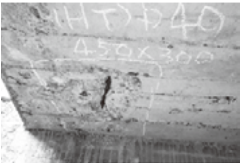
鉄筋が露出した橋の裏
